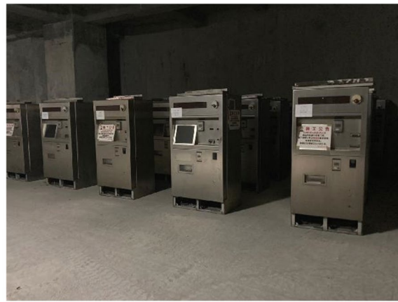
臺中BRT機電設備 (1,385,060元決標)
